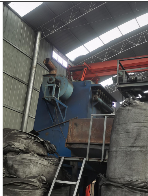
布袋除尘器排口无 15m 排气筒
