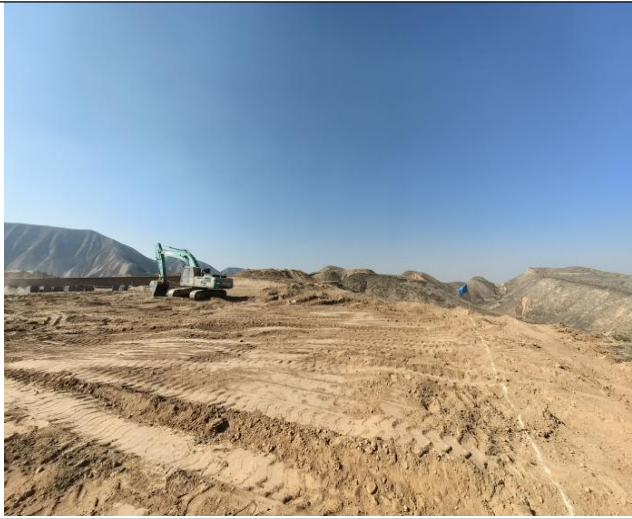
大红山升压站厂址
